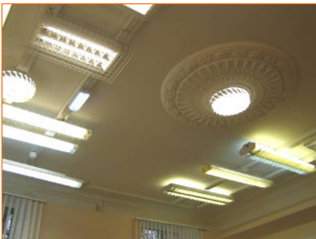
Фото 2. Образцы потолочных светильников, применяемых в школах Гомеля
