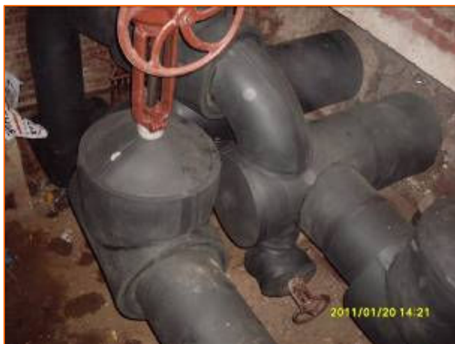
Фото 2. Тепловая камера, покрытая теплоизолирующим покрытием из вспененного каучука
